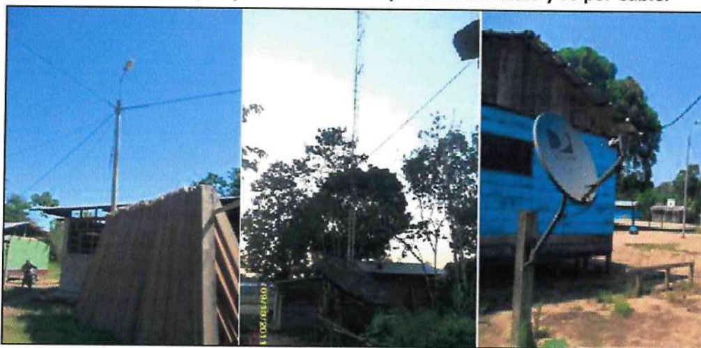
Ilustración 23, 24 y 25. Red Eléctrica, Antena de Radio y Tv por Cable.
