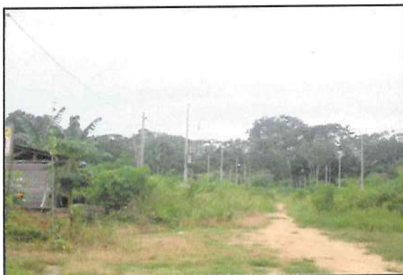
Figura 6. Cableado y Postes
