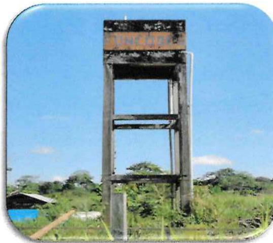
Foto N° 9. Tanque de Agua
