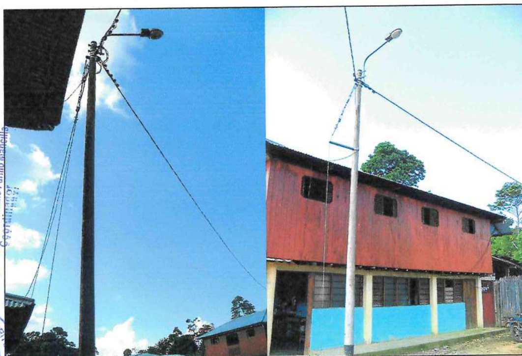
Foto N° 6: Red de postes y cableado eléctrico del centro poblado Itahuanía.
