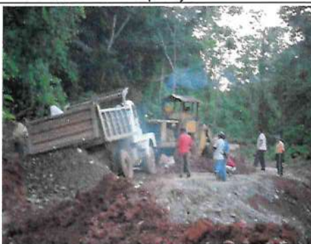
Foto N° 08: Mal estado de la carretera de acceso
