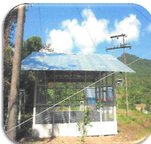
Sub estación eléctrica de Gamitana
